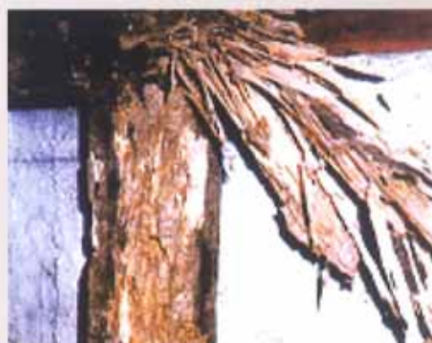
▲無残に喰い荒された床下
